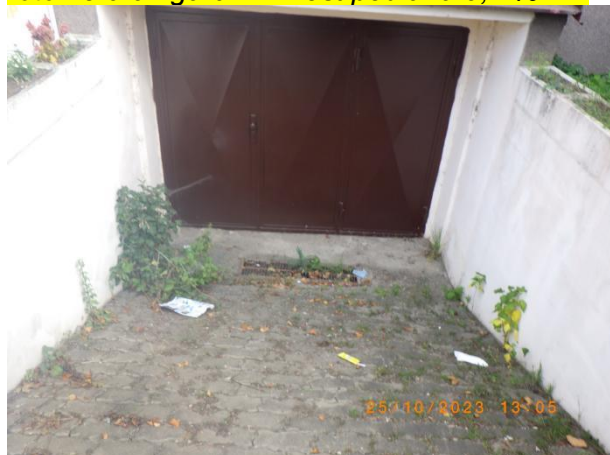
foto 17 nevhodně řešený detail odvodnění
