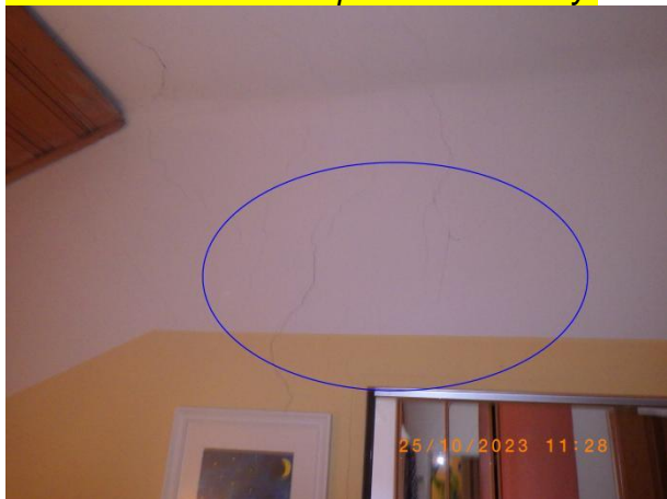
foto 41+42 2.01 schodiště stěny i strop s trhlinami
