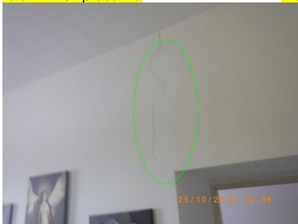
foto 29 1.04 pracovna trhliny zdivo
