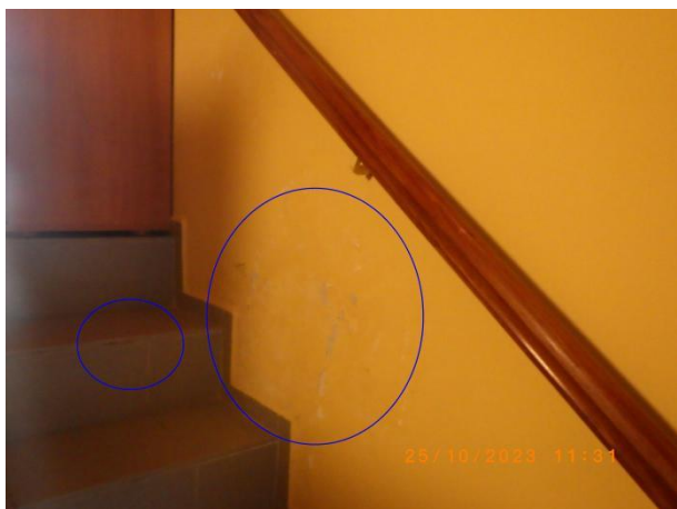
foto 39 2.01 schodiště poškození omítky
