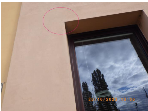
foto 31 1.04 pracovna trhliny fasáda
