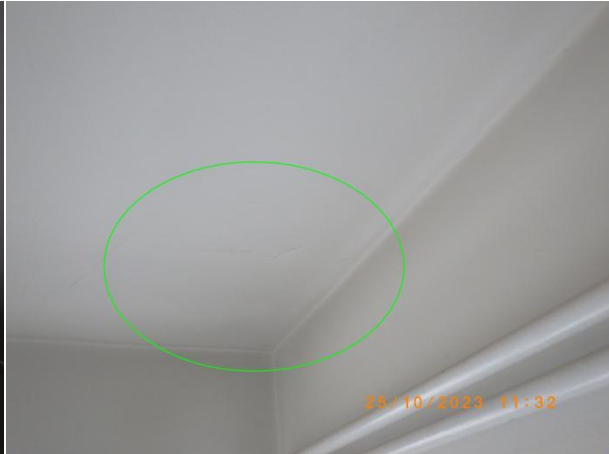
foto 52 2.06 chodba trhlina strop
