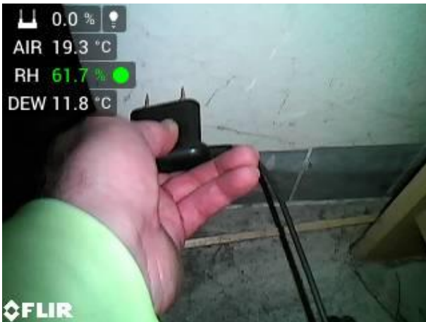
foto 07 +08 místnost 0.02 garáž vlhkost 1.5 % hm
