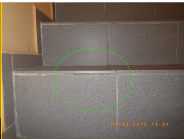
foto 40 schodiště 2.01 nevyplněné spáry
