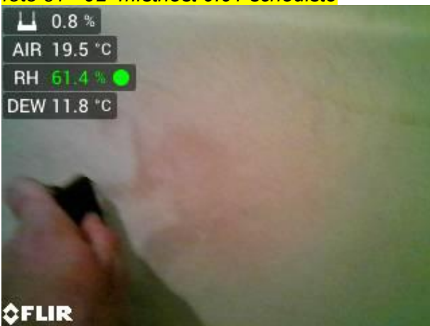
foto 03 0.01 schodiště vlhkost 0,8 % hm
