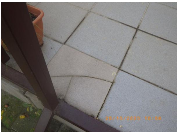
foto 57 poškozená venkovní dlažba terasy
