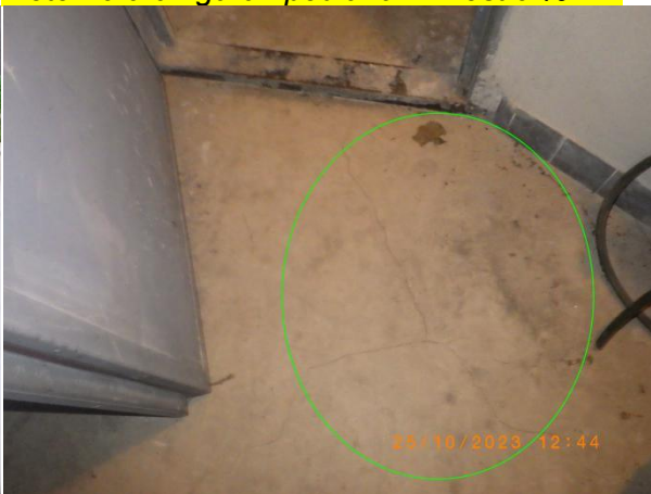
foto 18 0.02 garáž poškozený povrch podlahy
