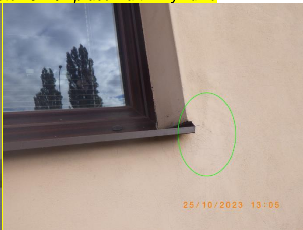
foto 30 1.04 pracovna trhliny fasáda
